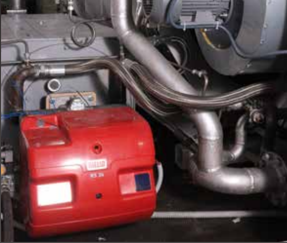
Gaz Isıtma Sistemi
