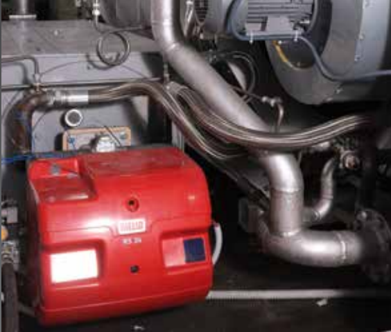
Gaz Isıtma Sistemi
